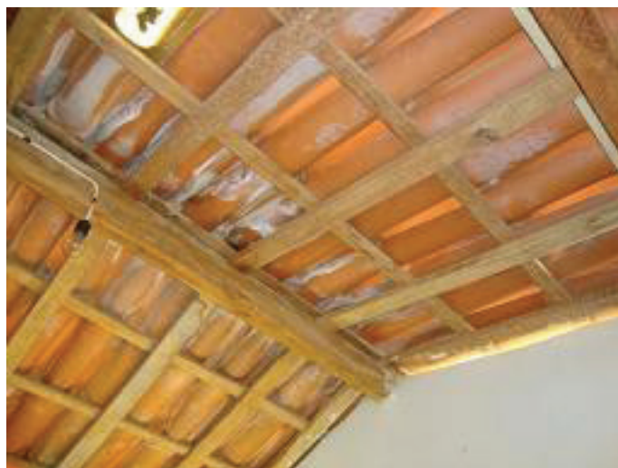
Foto: Escola São Cristóvão, em Maracás/BA: telhado da cozinha com frestas e sem forro (Relatório do Sorteio nº 38).
