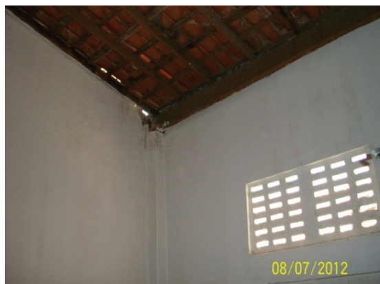
Foto: Grupo Escolar Edmundo Bezerra, em Japoatã/SE: cobogós sem a proteção de telas, telhado com frestas e inexistência de forro na despensa (Relatório do Sorteio nº 36).
