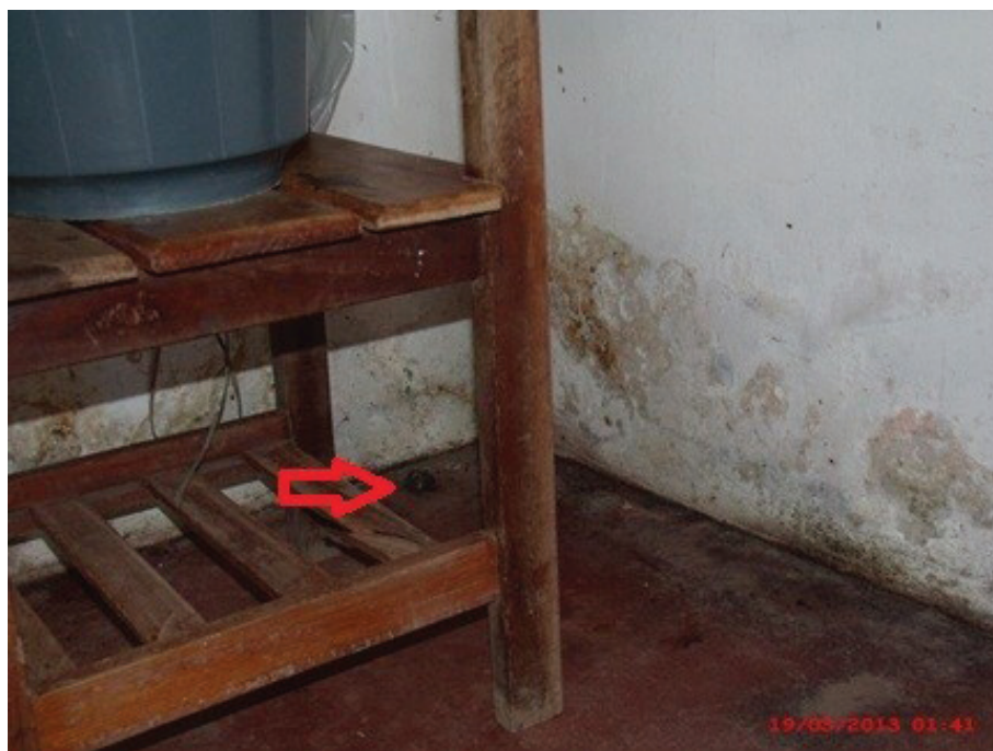
Foto: Escola do Jará, em Cachoeira do Arari/PA: condição inadequada de armazenagem em vista da presença de fezes de animais e piso sujo (Relatório do sorteio nº 38).
